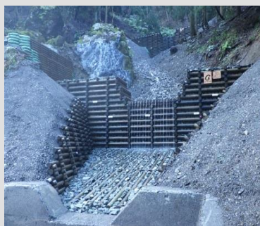
溪間工事にて福井県産の間伐材を用いた治山ダム設置
